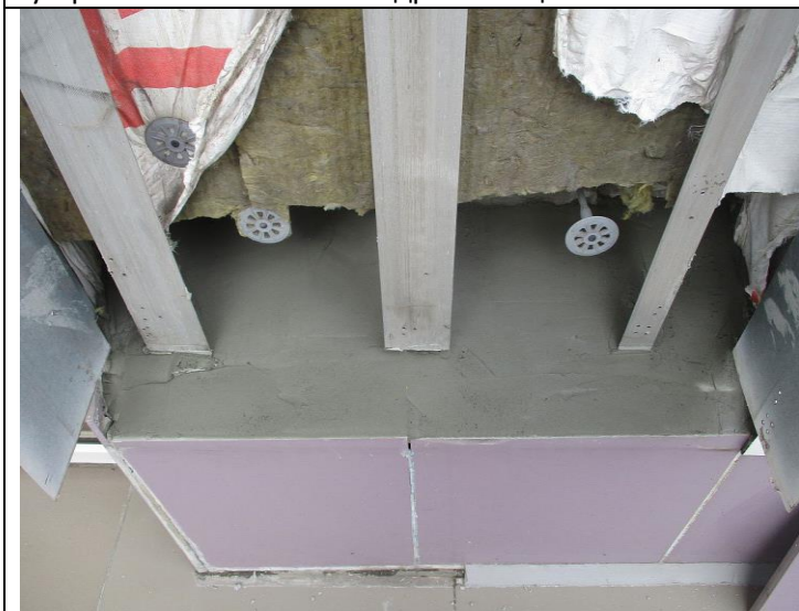
Кор.5, Сек.5, эт.1 Территория Устройство обмазочной гидроизоляции -подготовка поверхности -устройство обмазочной гидроизоляции
